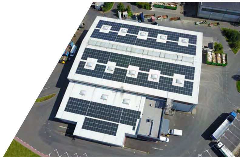
Photovoltaikanlage auf der Sperrmüllsortierhalle in Troisdorf
